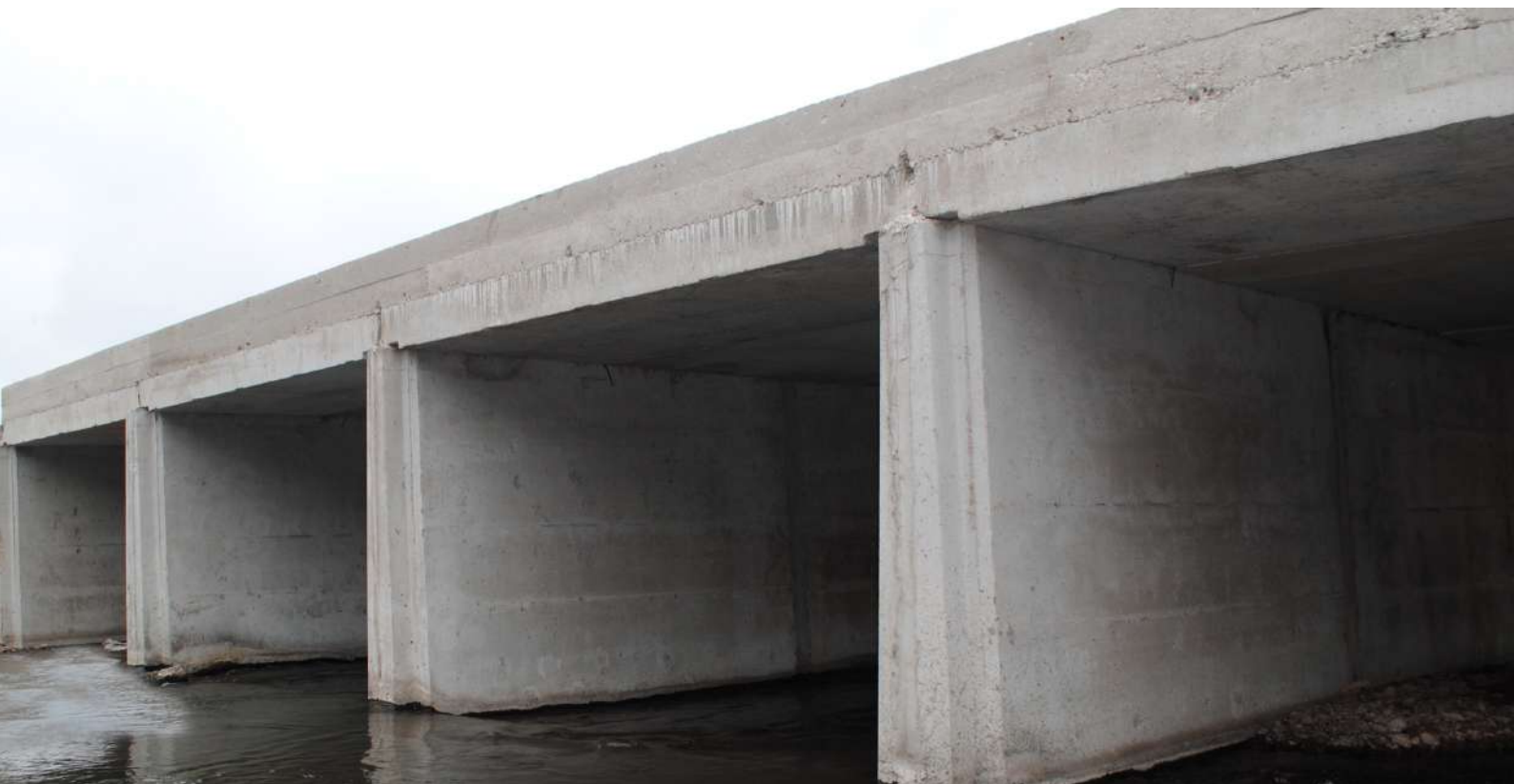
PASO DE CAÑADA “MANZO” - Cno. vecinal Dto. de Flores. 8 Alcantarillas Tipo CL1 (2015)
