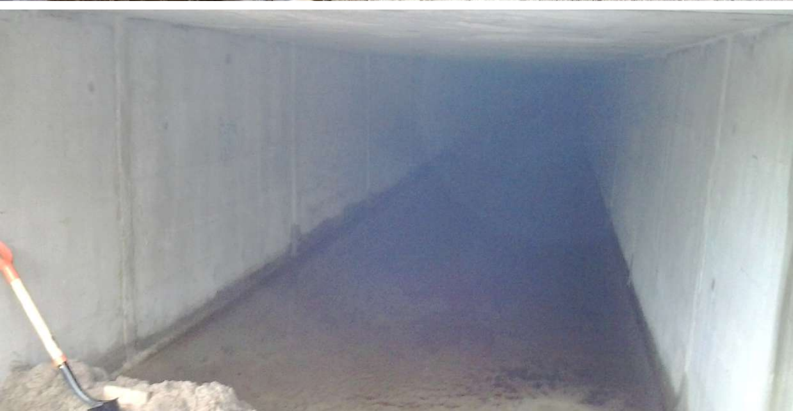
ALCANTARILLAS - Ciudad de la Costa
